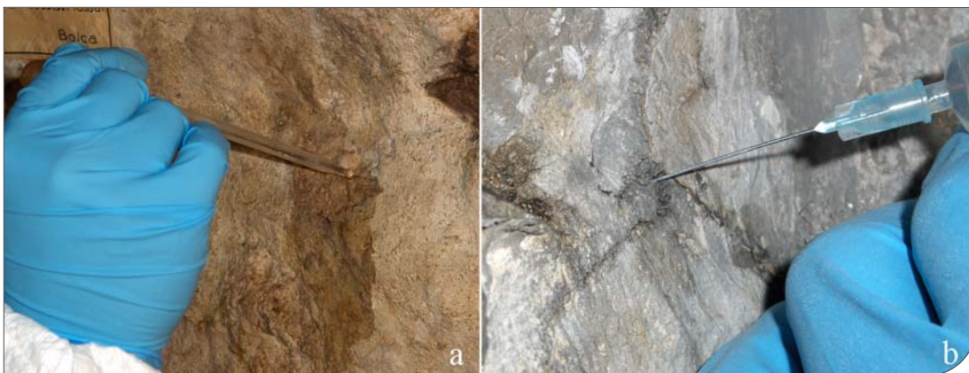
Fig. 2. Due momenti dell'applicazione del consolidante; a sinistra (a) applicazione per mezzo di pipetta, a destra (b) iniezione con siringa nelle fessure.
