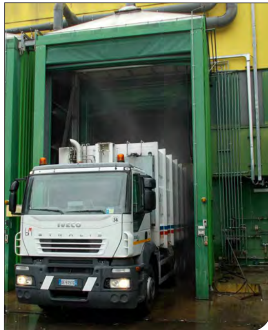
Fig. 3. Impianto per l'irrorazione di acqua intorno alle porte di scarico dei rifiuti.
